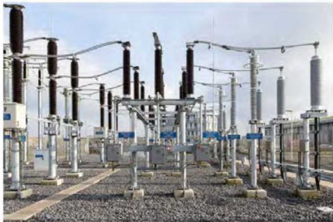
Een schakeltuin van Enexis en Tennet. © Enexis
